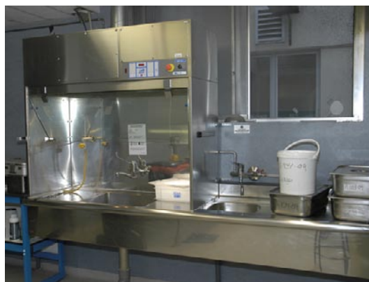
Foto 6: fregadero dotado de extracción localizada Fuente: Grupo Taper
